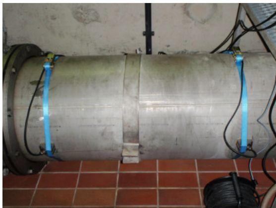
Druckrohrmessung mit Clamp-On
