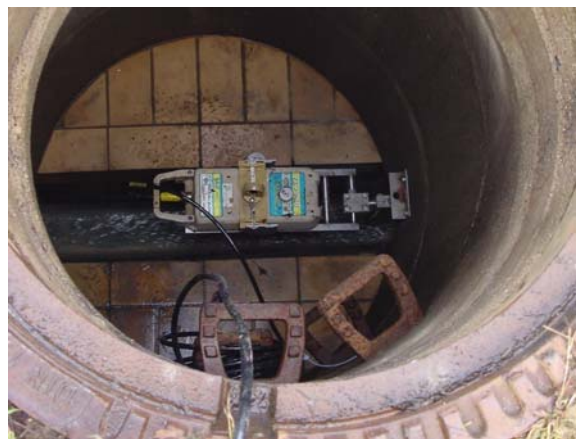
Sensorinstallation zur Kanalnetzdimensionierung
