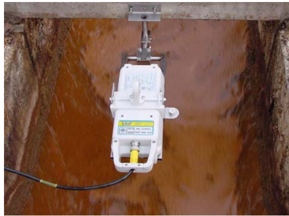
Sensorinstallation in einem chem. Abwasserkanal über Rechteckkanal
