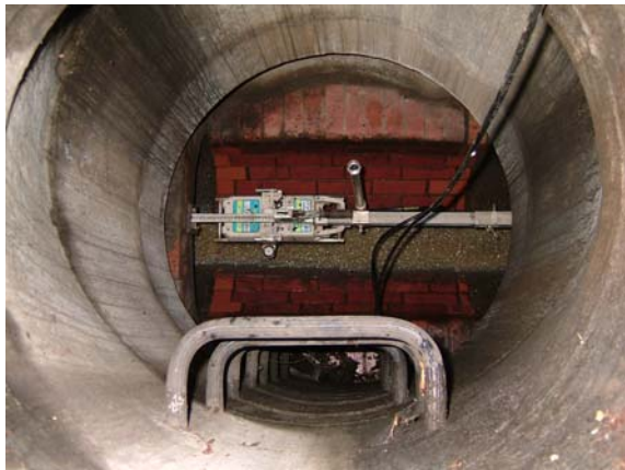
Sensorinstallation mit mobiler Spannhalterung zur Kanalnetzkalibrierung
