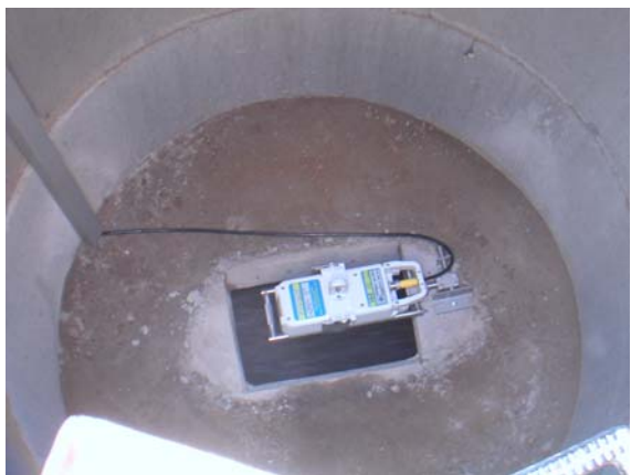
Sensorinstallation über geschlossener Rohrleitung. Fließgeschwindigkeit ( > 3 m/s) im Talsperrenauslauf
