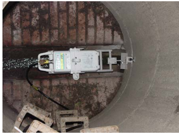
Sensorinstallation im Rahmen einer Messung zur Fremdwasserermittlung
