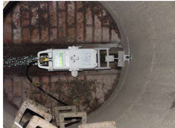
Sensorinstallation im Rahmen einer Messung zur Fremdwasserermittlung
