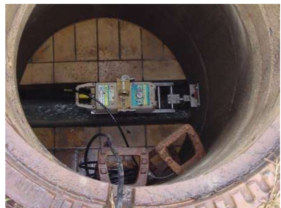
Sensorinstallation zur Kanalnetzdimensionierung
