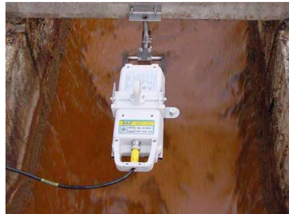
Sensorinstallation in einem chem. Abwasserkanal über Rechteckkanal
