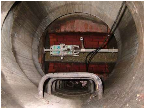
Sensorinstallation mit mobiler Spannhalterung zur Kanalnetzkalibrierung
